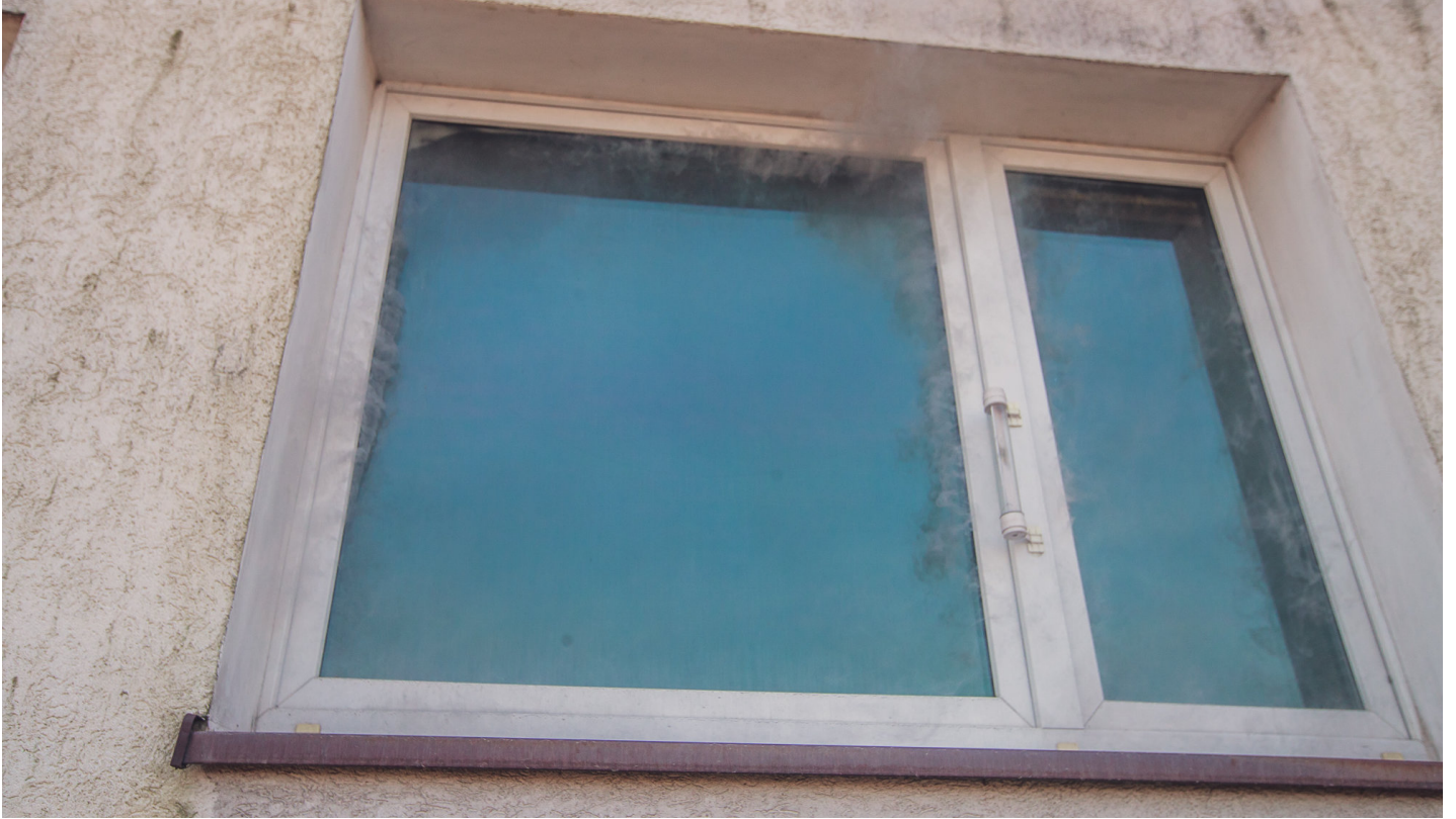
Fot. 20: Zewnętrzne oznaki pożaru nie zawsze są dobrze widoczne.
